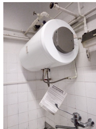
Figura 4.9 - Particolare di un boiler elettrico per la produzione di acqua calda sanitaria
