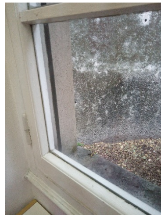
Figura 8.4 - Particolare serramenti da sostituire.
