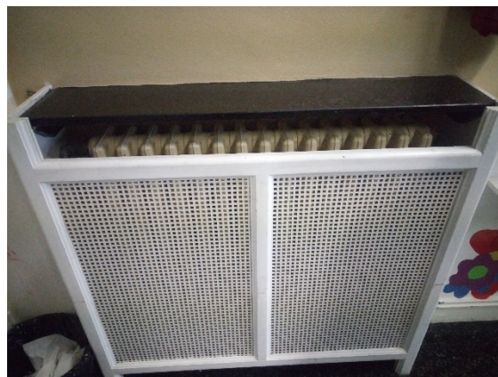
Figura 4.6 - Particolare radiatori senza valvole termostatiche
